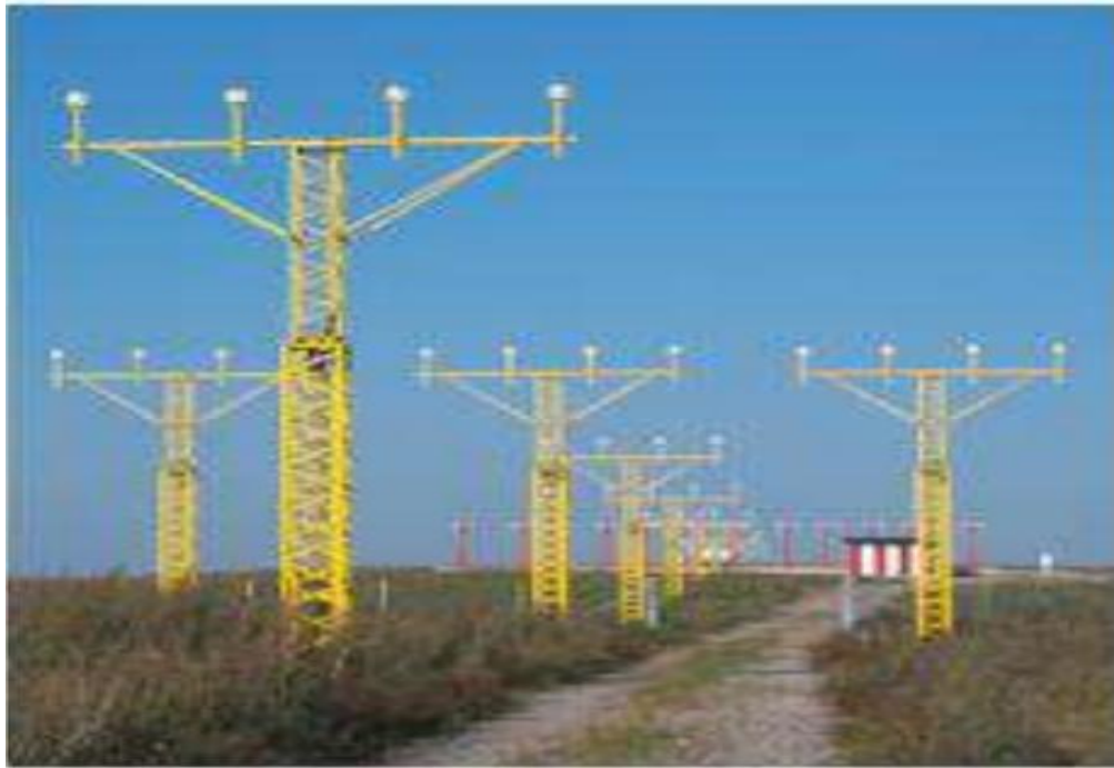
Figura 2-8-2. Torres de iluminación de aproximación de fibra de vidrio.
