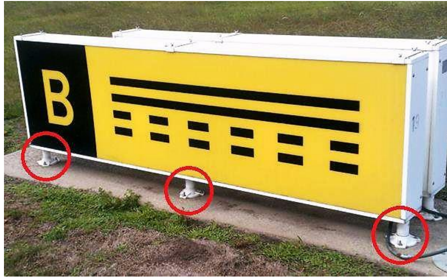
Figura 2-6-6. Ejemplos de Cuplas Frangibles en las instalaciones de los Letreros.
